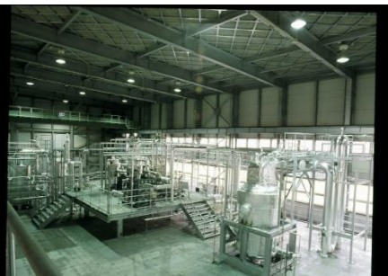
海洋温度差発電プラント
