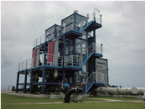
海洋温度差発電プラント
