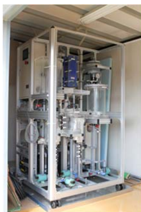
フラッシュ蒸発海水淡水化装置
