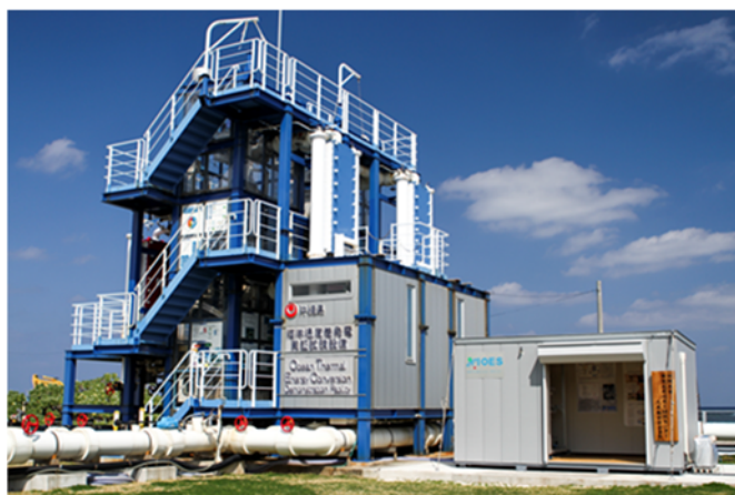
左／沖縄県海洋温度差発電実証設備
