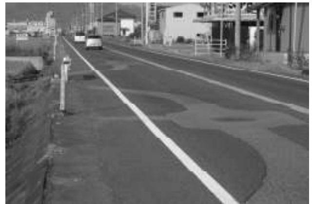
図 1 情報 BOX の埋設された道路 (国道 34 号線 佐賀県大町町) ※道路の色の違う部分が埋設跡
